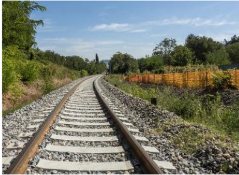
Due tratti della ferrovia Faentina minacciati dalle frane (foto Tedioli)
